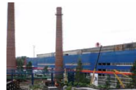
В 2015 году завершены работы по реконструкции трубопрокатного производства на Северском трубном заводе.
